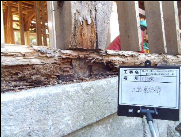
腐朽部 改修前
